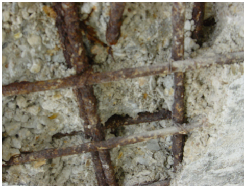
Figura 4 - "Chocos", "nichos de inertes" e armaduras oxidadas;
