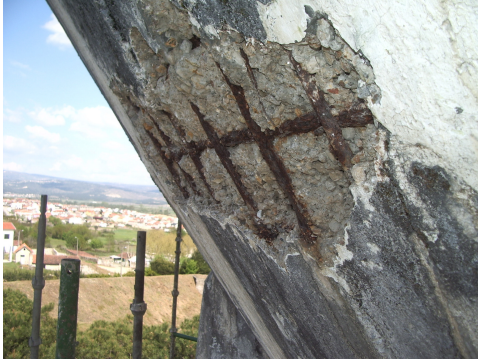
Figura 3 - Desagregação do betão na parede envolvente inferior;
