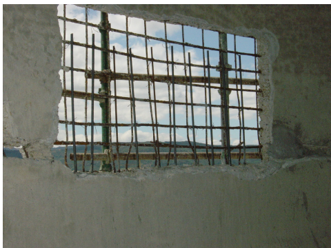
Figura 7 – Abertura adjacente à viga de coroamento;
